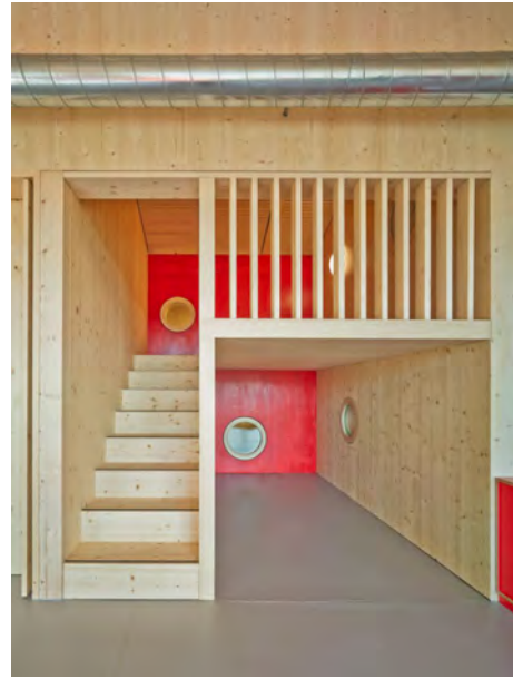
Galerie Absturzsicherung: Stoff-Netz
